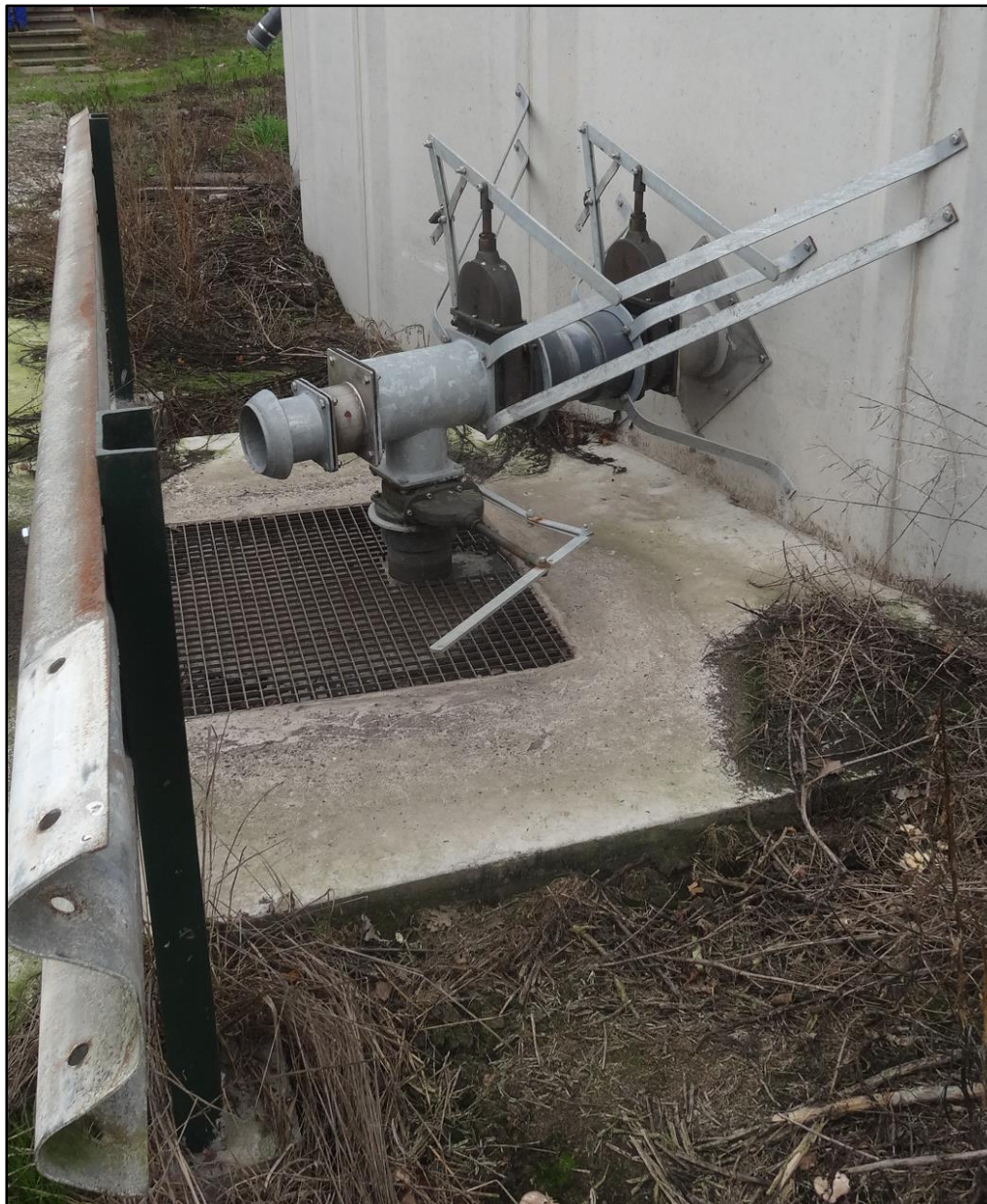
Rys. 1 Miejsce przepompowywania gnojowicy ze zbiornika głównego do wozu asenizacyjnego
