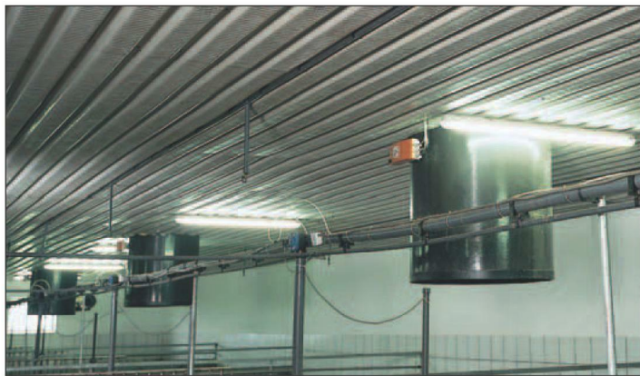
Wentylatory osiowe w budynku z sufitem typu Diff-Air
